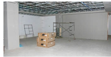
[Basement - AV Room]
